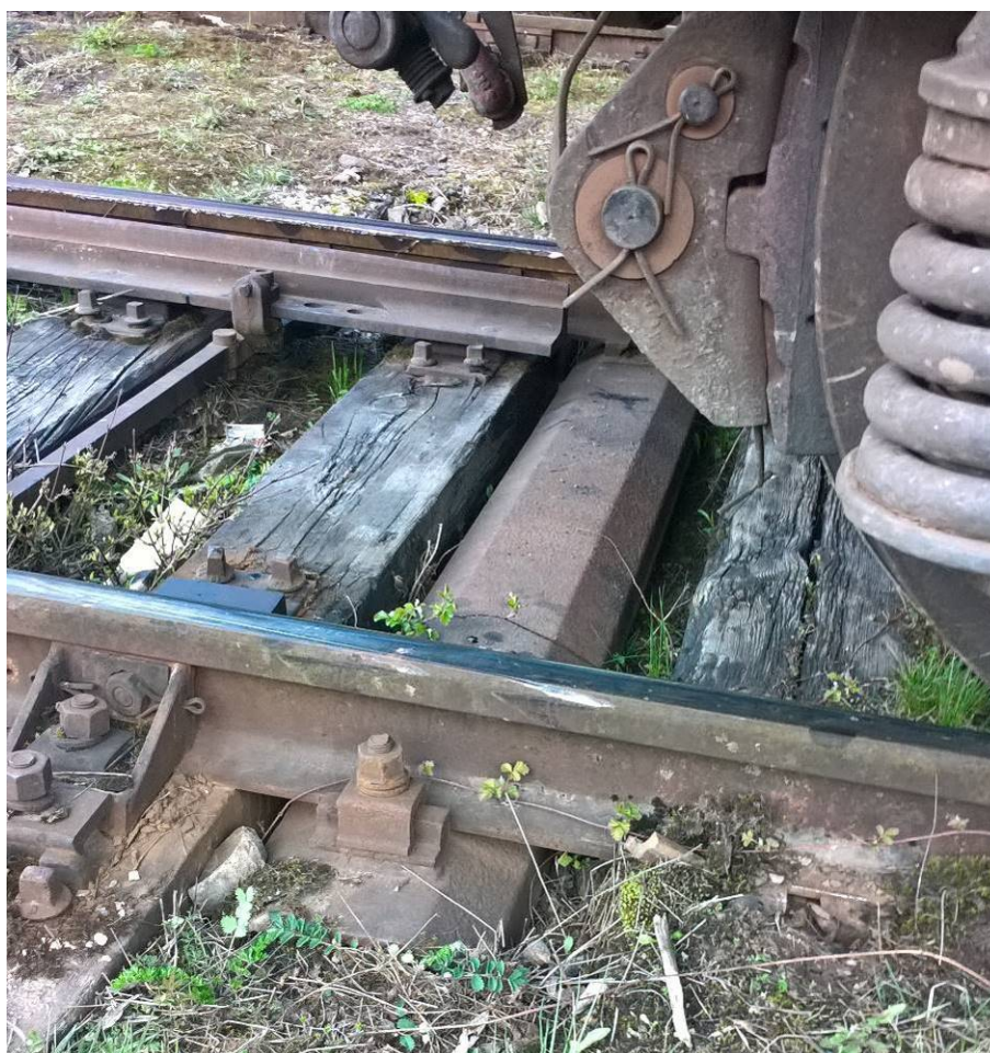
Rys. 74. Ślad wykolejenia na szynie
