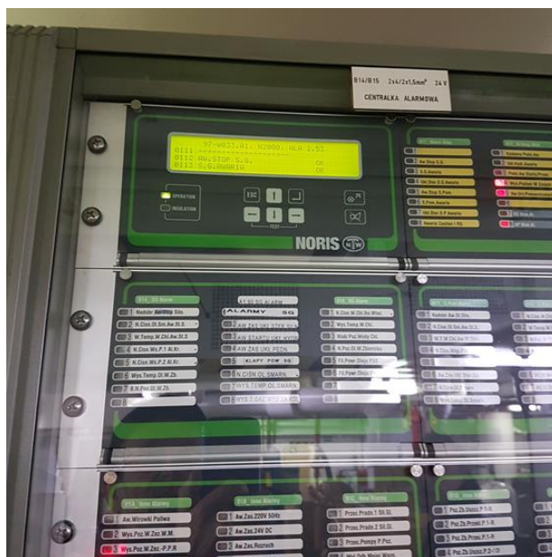
Zdjęcie 6 – Panel alarmów i informacji w siłowni promu
